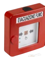
Pulsante di emergenza Fire alarm
